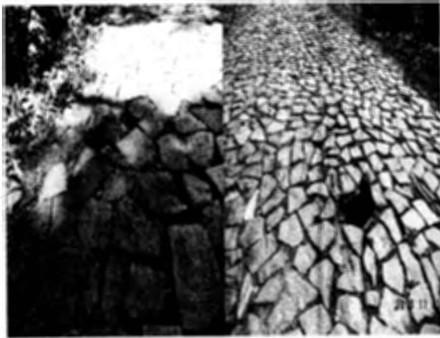
Foto 01: Pedras soltando em trechos do calçamento.
